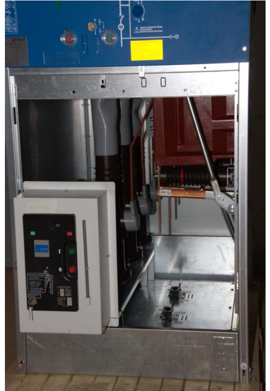
Отсек с силовым выключателем и ТТ
