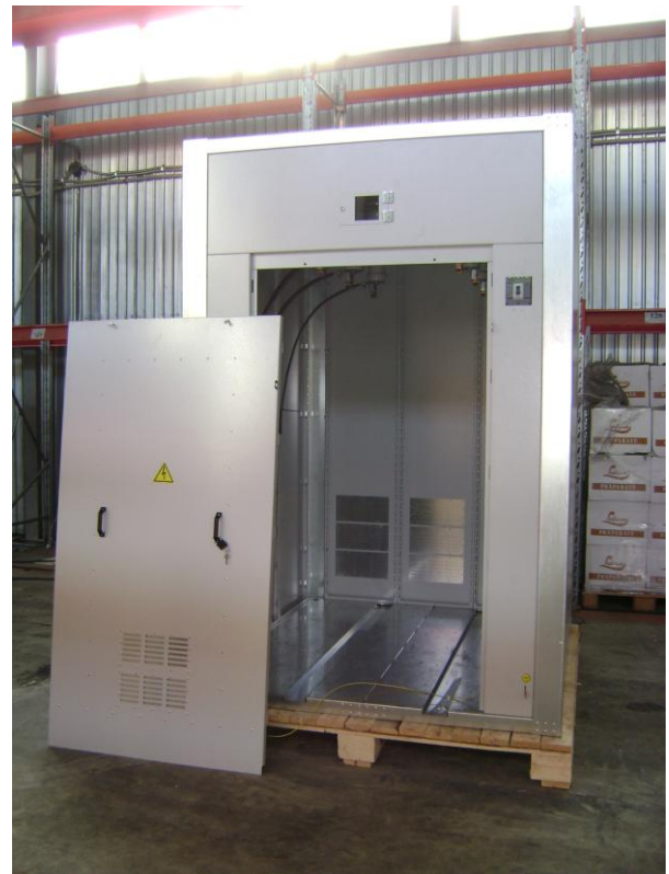
Шкаф ТСН с открытой панелью
