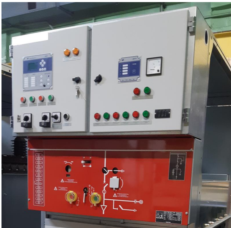
Активная мнемосхема на панели привода, сигнальные лампы на двери отсека вспомогательных цепей
