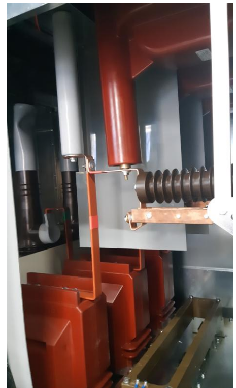
«Горизонт-35» ширина 1500мм Установка ТН до ввода, ОПН, ТТНП
