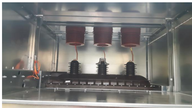
Отсек сборных шин с оптическим датчиком
