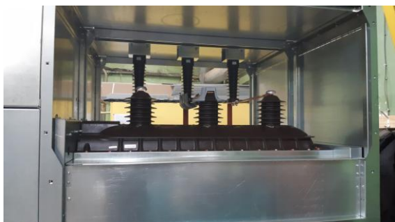
Отсек сборных шин
