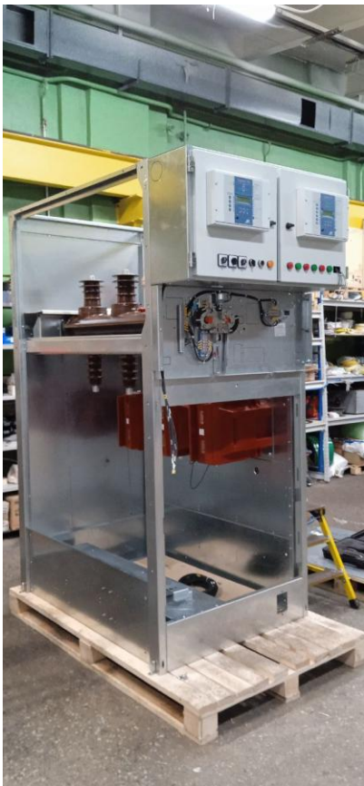
Отсек присоединений с выкатенным силовым выключателем
