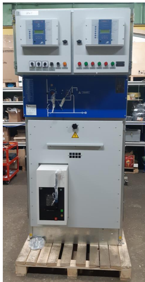
Наличие смотрового окна на двери отсека присоединений
